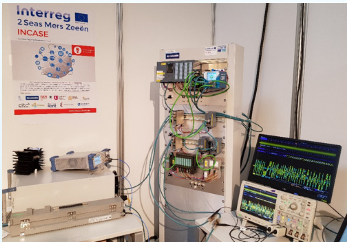
Démonstration lors du salon Indumation 2019 : couplage d'IEM sur un réseau PROFINET redondant.
